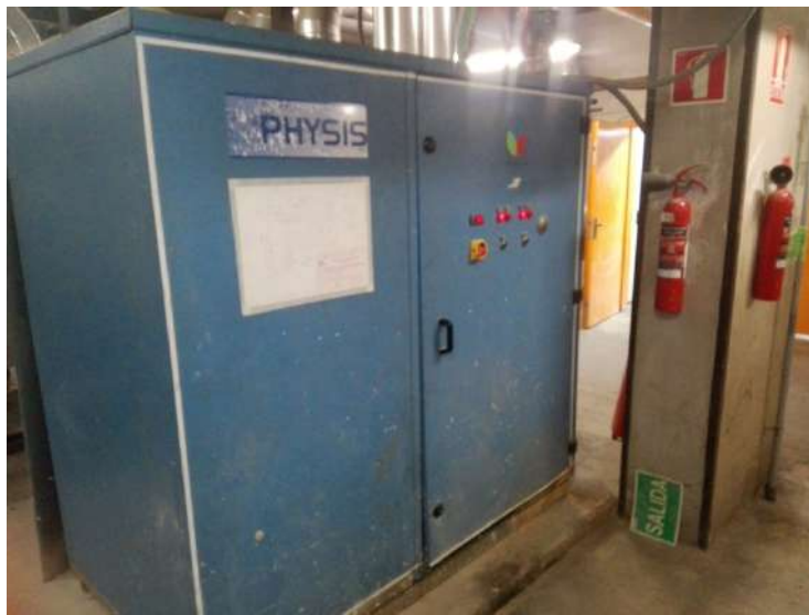
FIGURA 14. SISTEMA DE PASTEURIZACIÓN DEL ACS INSTALADO EN EL HCUV.
